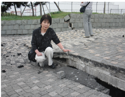
東扇島西公園の広場の亀裂・段差
