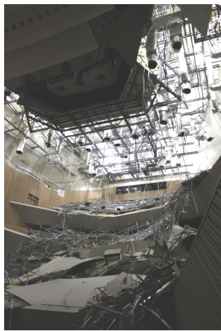
天井が崩落したホール
