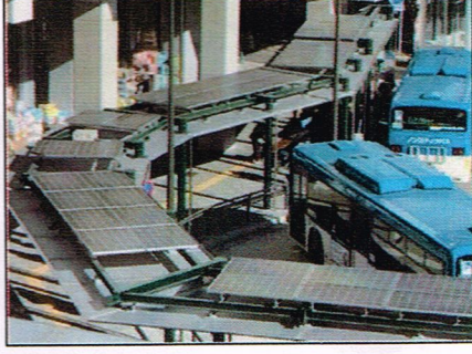
太陽光パネル
